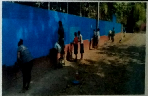
Foto 12: Vista exterior aplicación de pintura en muro frontal , apoyados por madres de familia.
