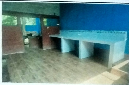
Foto 3: MODULO B COCINA Instalación de piso cerámico + elaboración de mueble de concreto con revestimiento de azulejo.
